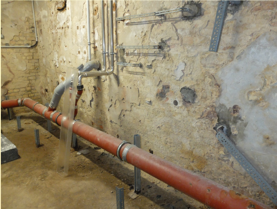
Stark durchfeuchtete Wand
